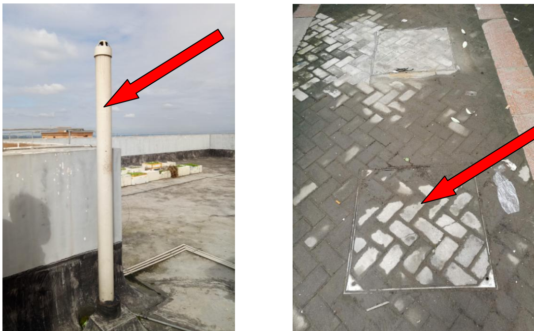
附图 7：化粪池盖板及楼顶废气排放出口
