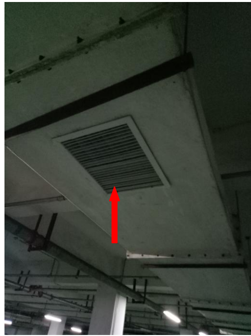
地下车库换风机
