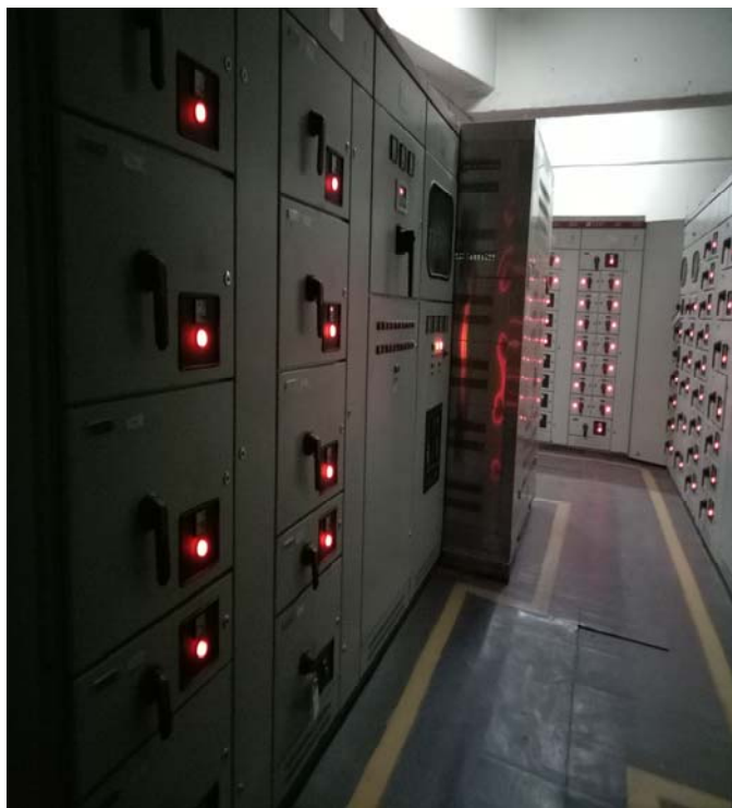
附图 9：变电房、加压水泵房、发电机房
